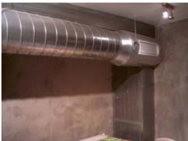
Wentylacja w Piwnicy
